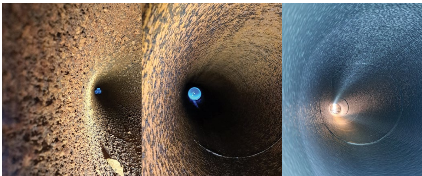
Rura przed oczyszczeniem
